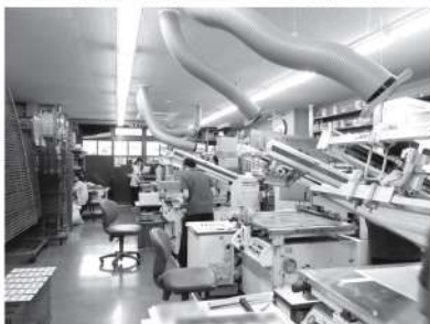
作業環境を守る換気ダクト
